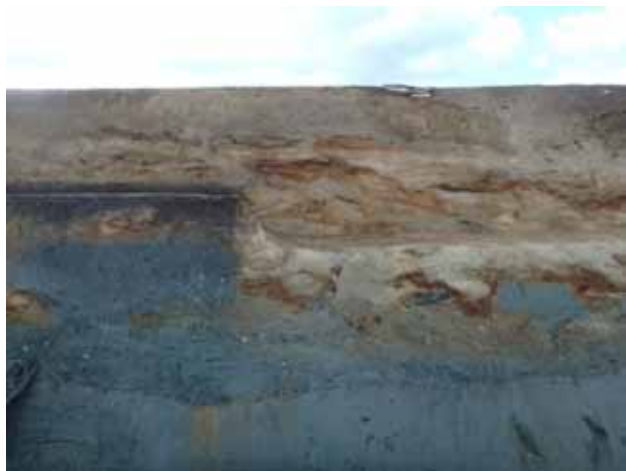
河床の削り込み
